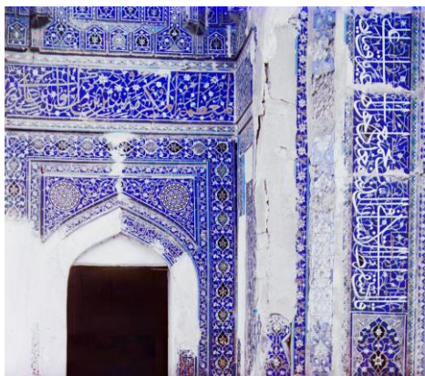
Рисунок 265 – Разрушенная мозаичная отделка Шах-Зинде
