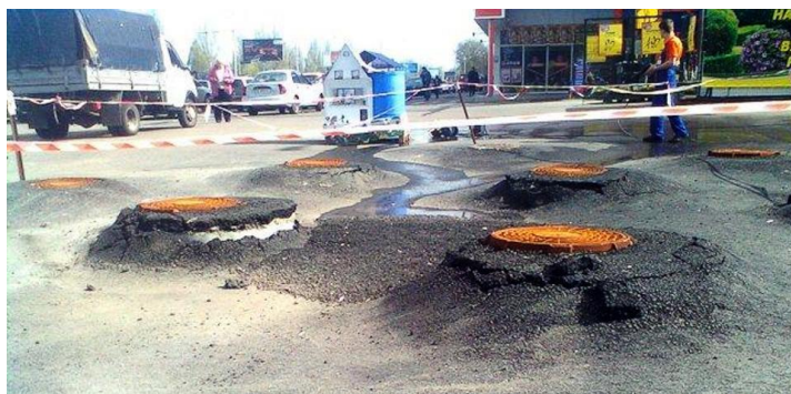
Рисунок 292 – Просадка грунта под проезжей частью
