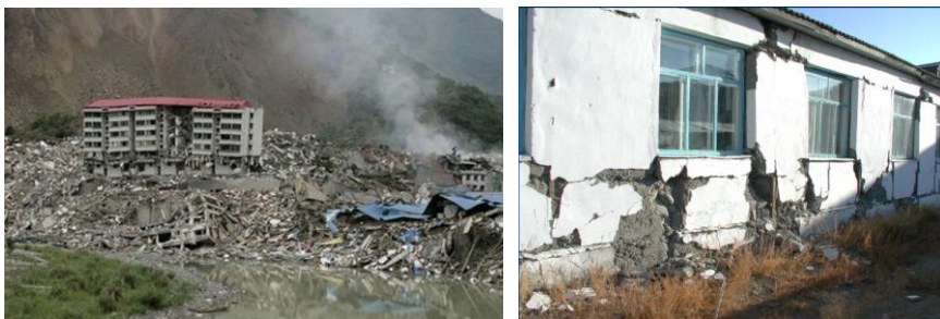
Рисунок 275 – Разрушение зданий в результате землетрясений
